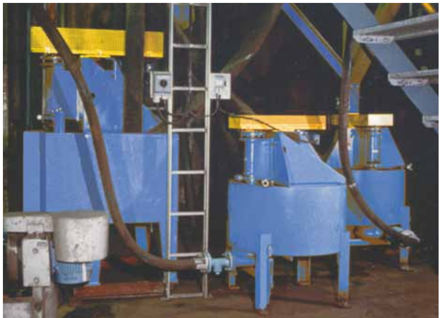
Pompes Metso VT pour pompage des concentrés, mixtes et résidus des spirales, dans le traitement des scories <2 mm.
