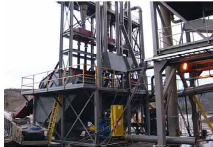
Tour d'hydrocyclones – HR
