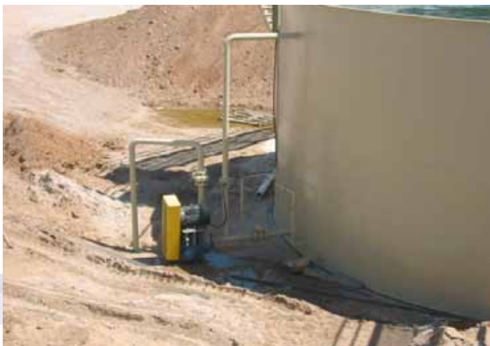
Sousverse de clarificateur
