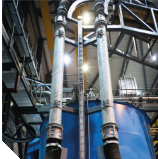
Mangueras y tuberías
