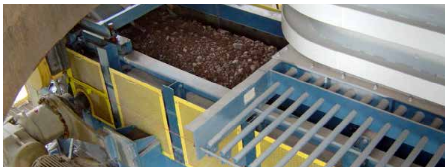
Vista superior da instalação de um Alimentador de Sapatas embaixo de um misturador de cru em uma grande planta de cimento.
