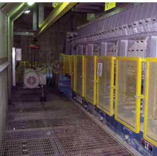
Alimentador de Sapatas instalado sob uma pilha pulmão de minério de cobre.
