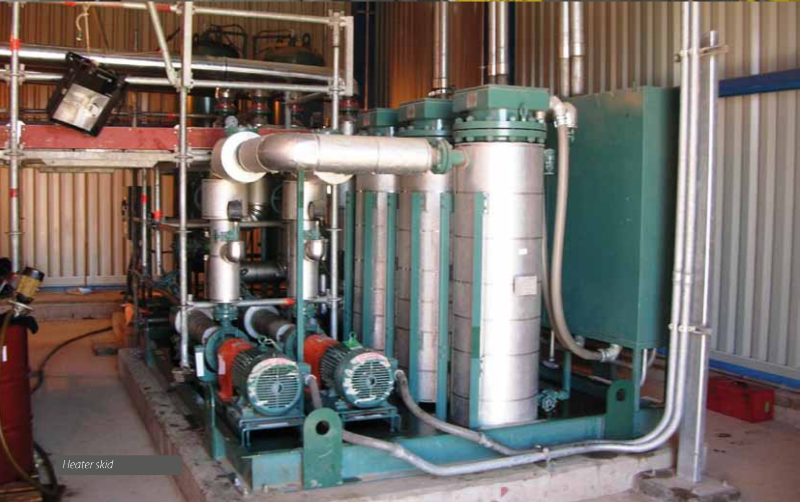
Dryer disch end
