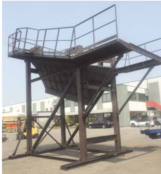
El pre-ensamblaje de la estructura antes de la pintura garantiza un montaje rápido y de alta calidad en obra.
