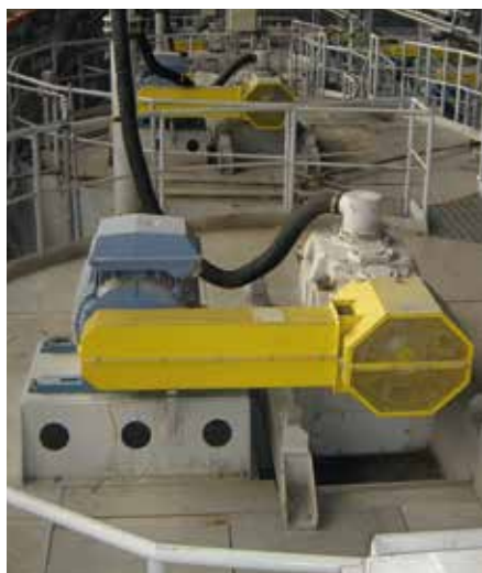
Acionamento por correia em V
