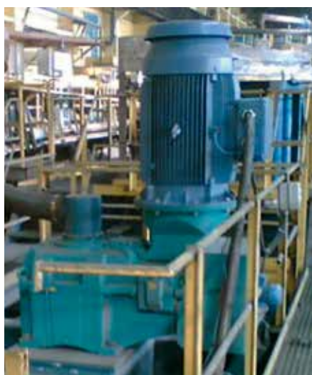
Acionamento por redutores
